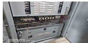
분전반 내부 관리상태 (양호)
