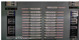
난향관 누전차단기 상태 (양호)
