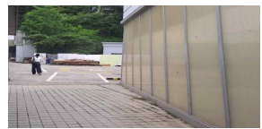
외벽 완충공간 확보 상태 (미흡)
