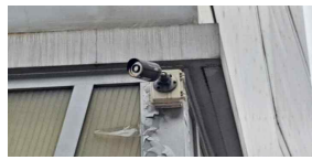
CCTV 설치 상태 (양호)
