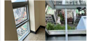
복도 창호 추락방지 조치 상태 (미흡)
