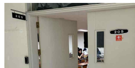
강의실(205호) 출입문 속도제어장치 미설치 (미흡)
