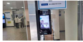
야간 출입문 출입통제 (양호)
