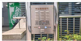
외진공간 주변 비상벨 설치 (양호)
