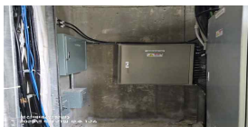
EPS/TPS실 내부 관리상태 (양호)
