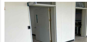
강의실(706호) 출입문 속도제어장치 미설치 (미흡)
