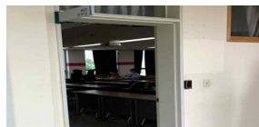
강의실(603호) 출입문 속도제어장치 미설치 (미흡)
