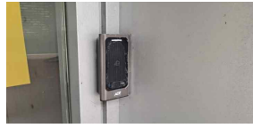
야간 출입문 출입통제 (양호)
