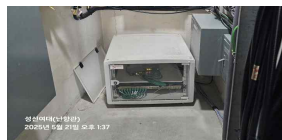
EPS/TPS실 장비이격거리 확보 (양호)
