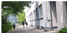
외벽 완충공간 확보 상태 (미흡)
