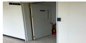
강의실(302호) 출입문 시창 설치 (양호)
