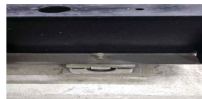
예비발전설비 방진장치 설치 (양호)
