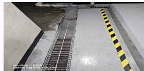
수변전실 트렌치 설치 (양호)
