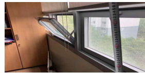
교수연구실 창호 추락방지 조치 (양호)
