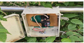
옥외 전로 누전차단기 설치 (양호)
