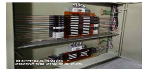
분전반 내부 관리상태 (양호)
