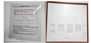
수변전실 내 단선결선도, 기기조작순서 부착 (양호)
