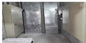
EPS/TPS실 장비이격거리 확보 (양호)
