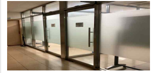
실습실 출입문 비산방지 필름 부착높이 미달 (미흡)
