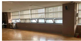
생활체육실 창호 추락방지 조치 (양호)
