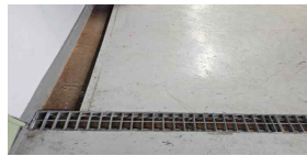
수변전실 트렌치 설치 (양호)
