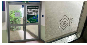
1층 출입문 복층유리 사용 (미흡)
