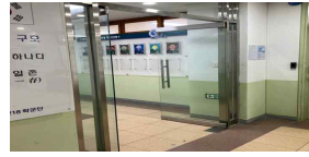
2층 복도 출입문 비산 방지필름 미부착 (미흡)
