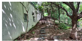
외벽 완충공간 확보 상태 (미흡)
