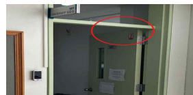
실습실(601호) 출입문 속도제어장치 미설치 (미흡)
