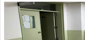
강의실(308호) 출입문 속도제어장치 미설치 (미흡)
