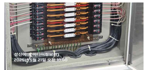
분전반 내부 관리상태 (양호)
