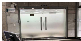
강의실(101호) 출입문 시창 설치 (양호)
