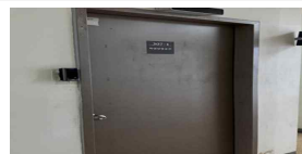
학생창업공간(307-1호) 출입문 시창 미설치 (미흡)
