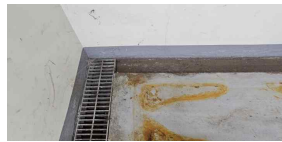
수변전실 트렌치 설치 (양호)
