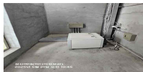
EPS/TPS실 장비이격거리 확보 (양호)
