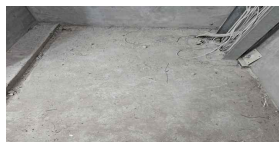
EPS/TPS실 바닥분진 관리상태 (미흡)
