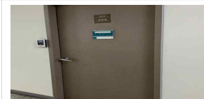
원장실(202호) 출입문 시창 미설치 (미흡)
