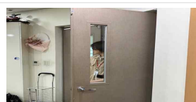
강의실(203호) 출입문 속도제어장치 미설치 (미흡)
