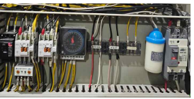
옥외 전로 누전차단기 설치 (양호)
