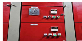
소방펌프 기동상태 (양호)
