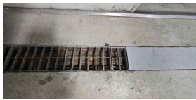
수변전실 트렌치 설치 (양호)
