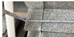
계단 유효너비 확보 상태 (미흡)
