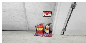
전기실 소화기 관리 상태 (양호)
