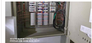
분전반 내부 관리상태 (양호)
