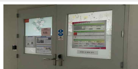
공동연구실(451호) 출입문 시창 가림 (미흡)
