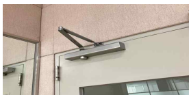
융합실기실(807호) 출입문 속도제어장치 설치 (양호)
