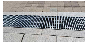
배수트렌치 덮개 틈새 간격 상태 (미흡)
