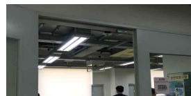
교육실험실(755호) 출입문 속도제어장치 미설치 (미흡)
