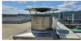
보일러 배기연도 설치 상태 (양호)
