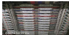
분전반 이중보호덮개, 사용위치명 부착 (양호)
