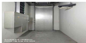
EPS/TPS실 내부 관리상태 (양호)
