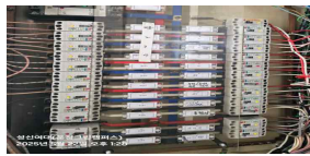
운정그린캠퍼스 누전차단기 상태 (양호)
