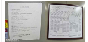
수변전실 내 단선결선도, 기기조작순서 부착 (양호)
