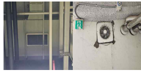
보일러실 환기설비 설치 (양호)
