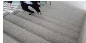
계단 논슬립 설치 상태 (미흡)
