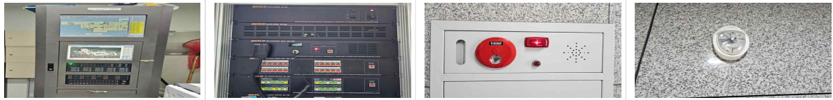
경보설비 상태 (양호)
