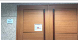
대강당(201호) 출입문 시창 미설치 (미흡)
