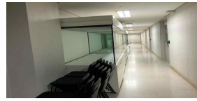
지하 1층 복도 보행 장애물 적치 상태 (미흡)
