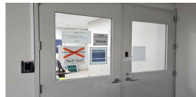
방음실기실(101호) 보안시스템 설치 (양호)
