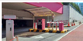
차량진출입구 주차관제 시스템 설치 (양호)
