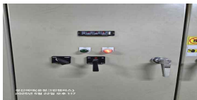
분전반 상시/일반전원 분리 상태 (양호)
