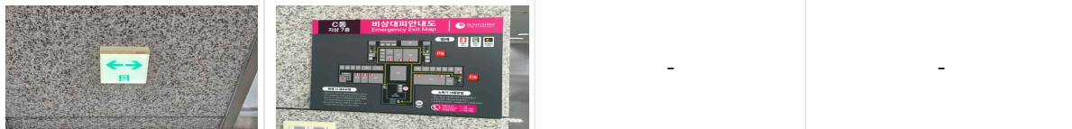
피난유도등 관리 상태 (양호)
