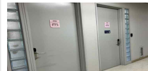
교수연구실(546호) 출입문 시창 미설치 (미흡)
