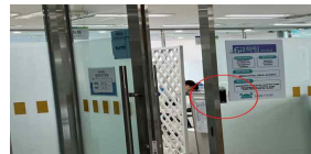
제6교학팀(924호) 보안시스템 설치 (양호)
