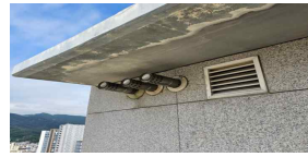
보일러 배기연도 설치 상태 (양호)
