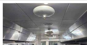
조리실 자동확산소화기 관리 상태 (양호)
